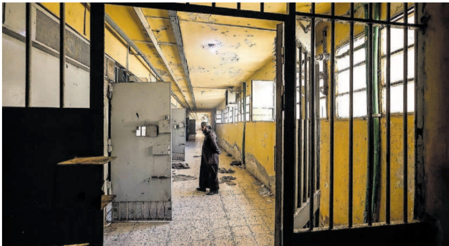
Dependencias de la prisión de Saidnaya, al norte de Damasco (Siria), ayer. ÁLVARO GARCÍA
